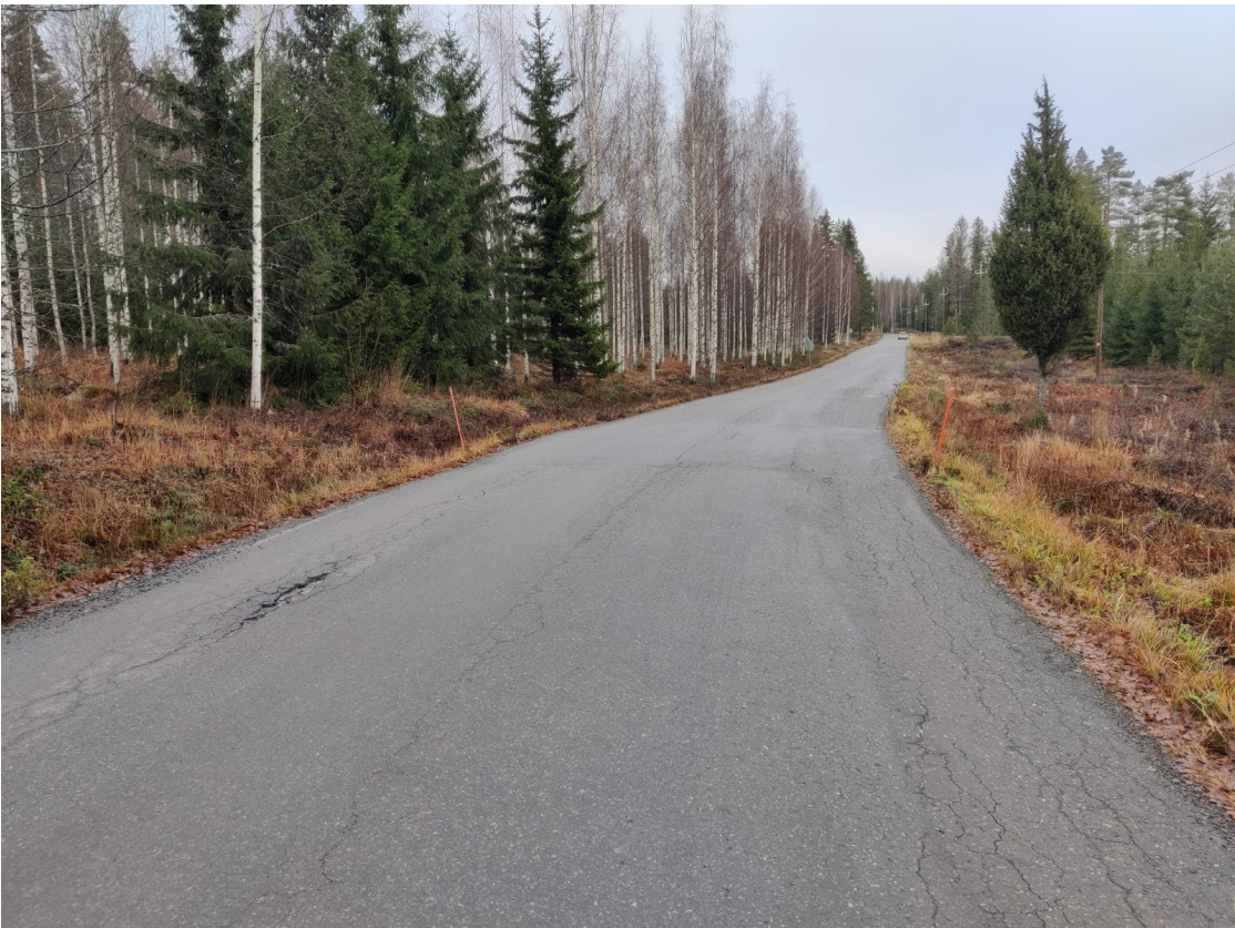
Kuva 5. Paalu 660. Merkittävä routanousu paalulla 670 sekä päällysteen verkkohalkeamaa.
