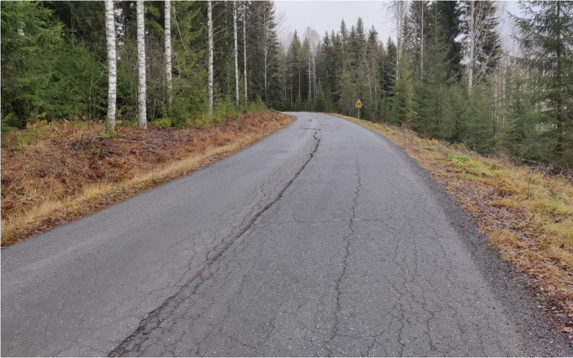
Kuva 4. Paalu 200. Muun muassa tien pituussuuntaista halkeamaa sekä laaja-alaista verkkohalkeamaa.
