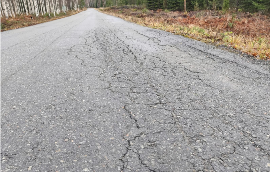
Kuva 6. Paalu 690. Merkittävä painuma tiessä.
